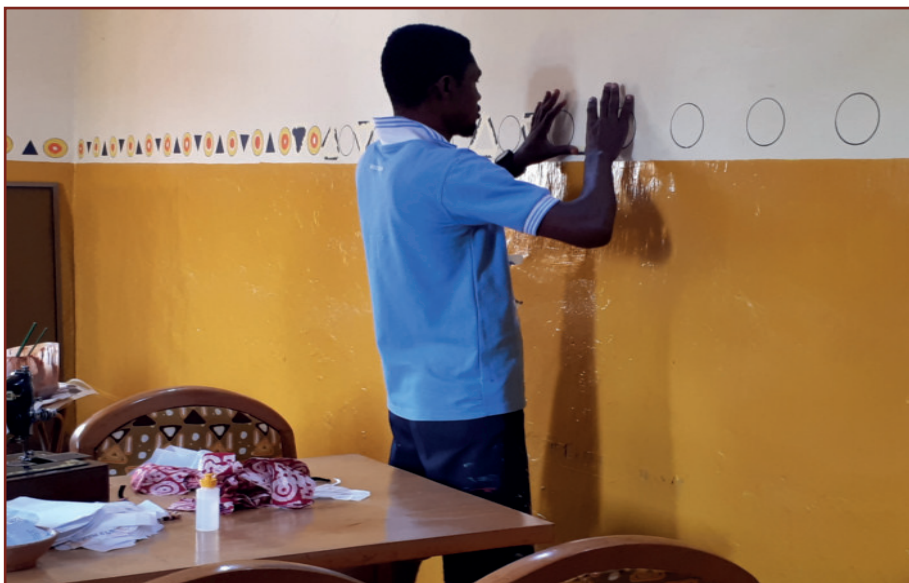
Isaac, unser Chef de Restaurant, hat schon alle Malerarbeiten mit einem Kollegen der Schule übernommen und malt nun noch ein Design im Konferenzraum.
